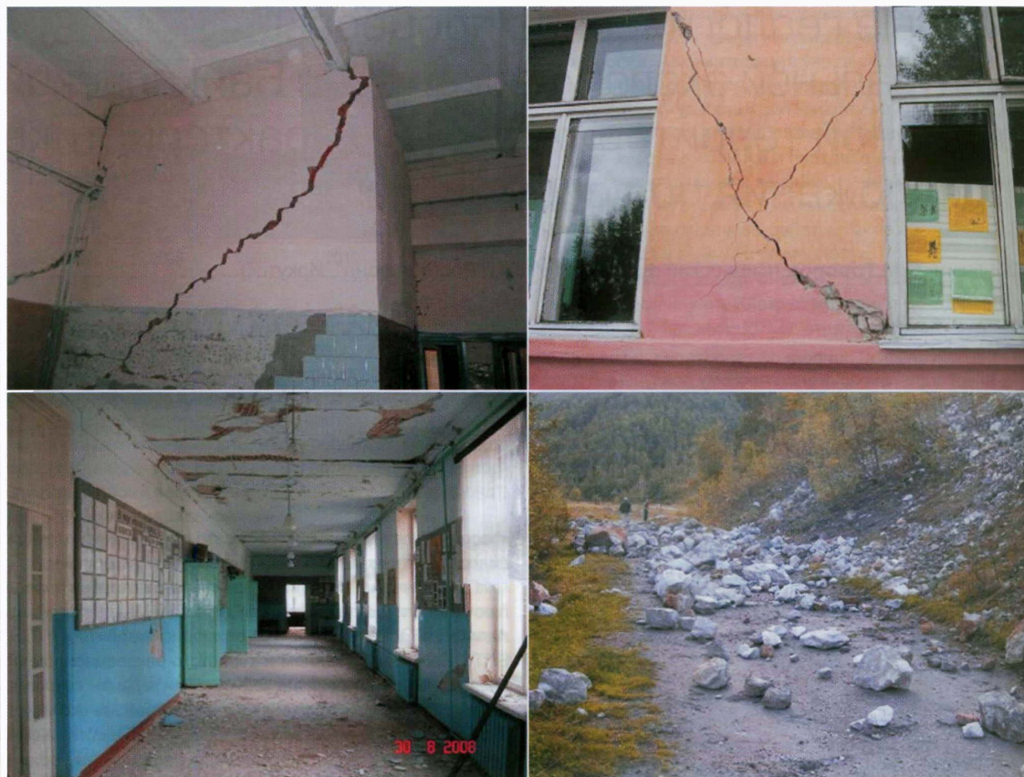
Рис. 1. Последствия 8-балльного землетрясения на юге Байкала 27 августа 2008 г. в г.Слюдянка и пос.Култук
