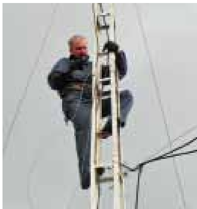
Установка конт- роллера на ОГМС Багдарин
